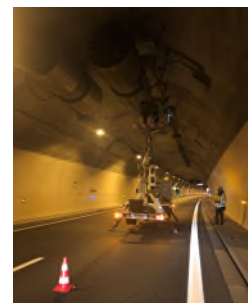
Vérification des ventilateurs
