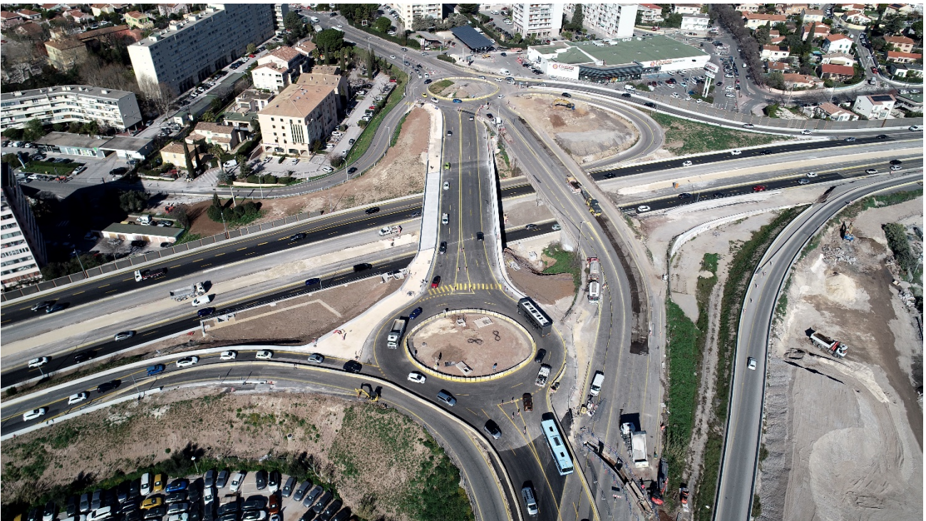
Elargissement A57 - 7 février 2024 : ouverture à la circulation du nouveau pont de Tombadou - Photo Elite Drone
