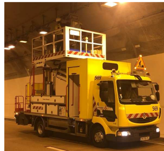
Vérification et remplacement de l'éclairage
